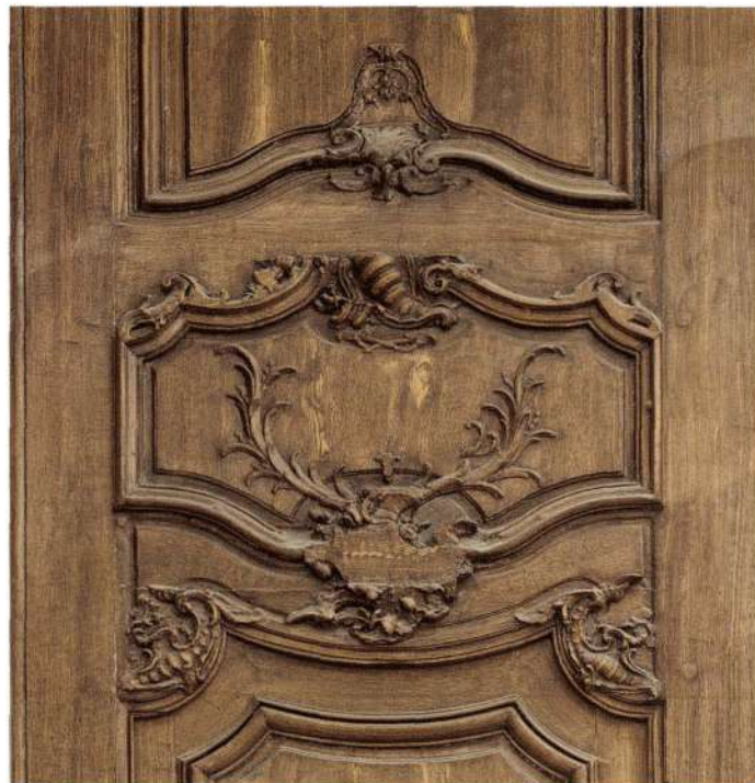
L'hôtel de la Sirène, 33, rue du Général-Leclerc : détail des deux vantaux sculptés de motifs rocaille.
