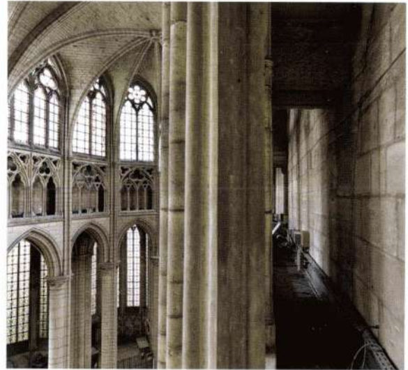
Le triforium du chœur abrite une étroite galerie de circulation. Le mur extérieur, nu et aveugle, contraste avec le décor raffiné tourné vers l'intérieur de la cathédrale.
