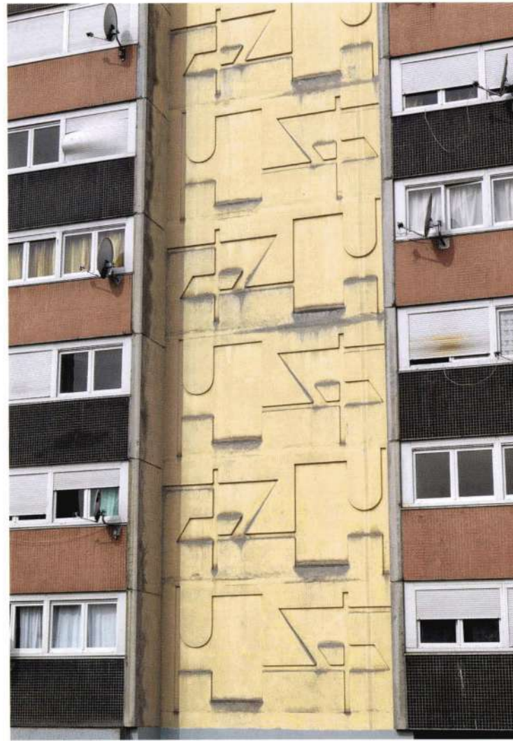
Une tour de la Pierre-Collinet en 2009 : détail de la mise en œuvre du béton moulé sur la façade arrière.
